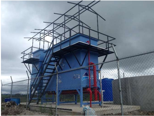
Ilustración 23. Planta modular de agua potable y reservorio. Fuente: archivo propio, 2017
