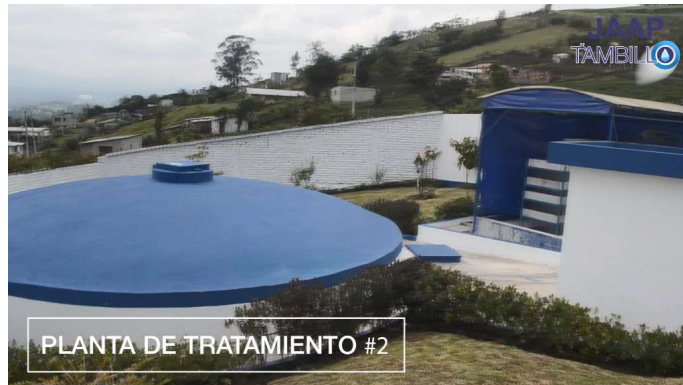
Ilustración 7. Planta de Tratamiento 2 de la JAAPT. Fuente: JAAPT, 2018.
